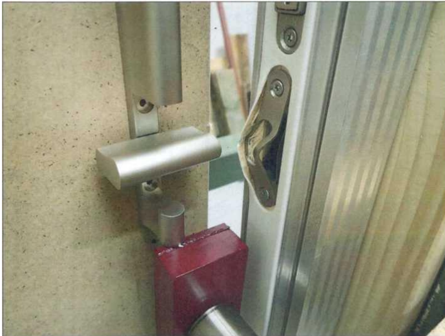
fot. 7 – blacha czołowa zamka WC G 500 – stan po badaniu nr 3
